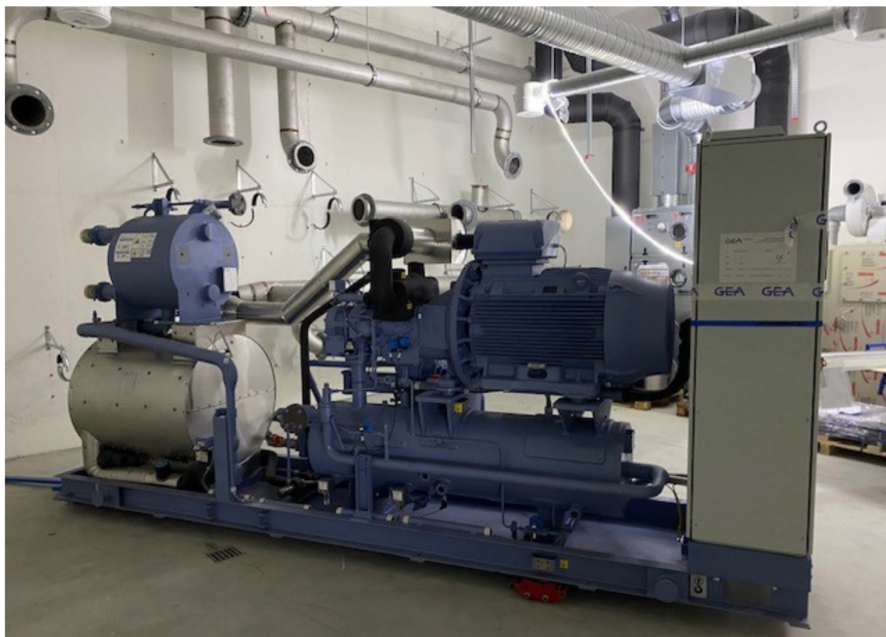
Figur 3 Sjukehuset Nordmøre og Romsdal (SNR), Varmepumpe/kjøleaggregat – 450 kW – ammoniakk som kuldemedium (100 % miljøvennlig) – turtallsregulert kompressor (trinnløs kapasitetsregulering) med meget lang levetid (Kilde: Cowi)
